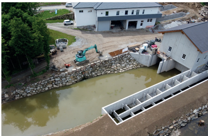
Die Fischaufstiegshilfe wurde mithilfe von Betonfertigteilen erstellt. Sie wird den Bewohnern der Großen Mühl ein problemloses Passieren der Anlage ermöglichen.
